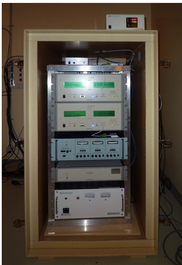
写真2 恒温槽の中に設置された 磁力計制御部とデータ収録部
