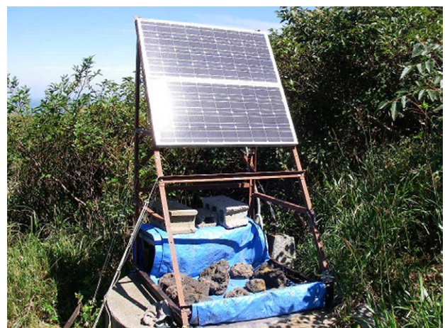
写真 1 太陽電池式電源装置 (ASJ)
