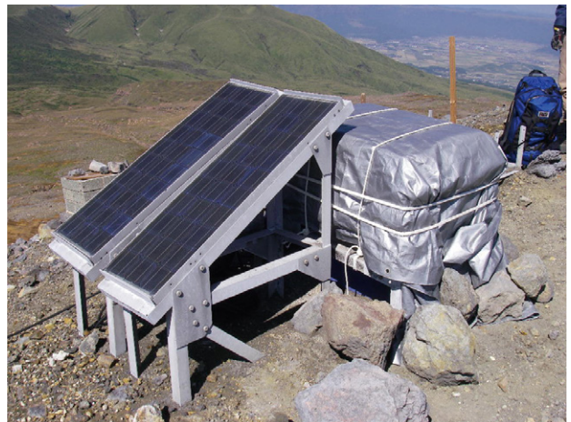
写真3 CW 電源装置改修後
